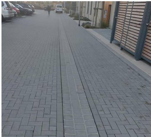
Abbildung 4-1: Regenwasserableitung mittels Zeilerrinne, eigenes Foto
